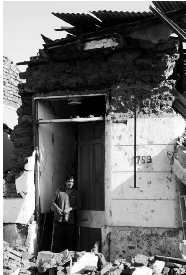
Efectos del terremoto del 27 febrero de 2010 en Talca. Fotografía: Alexis Martínez.
